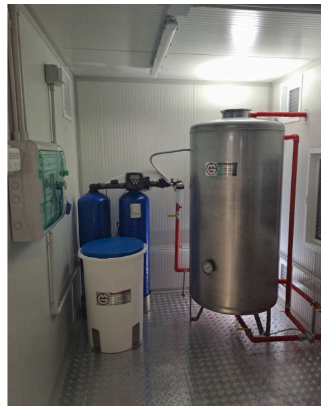
GENERATORI DI VAPORE ELETTRICI+GAS IN CONTAINER, PARTICOLARE DEL SERBATOIO DI ALIMENTAZIONE -RITORNO CONDENSE E DELL'ADDOCLITORE A DOPPIA COLONNA
